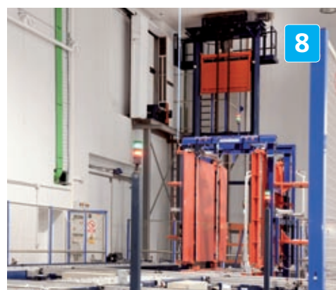
I trasportatori a rulli o a catene, la postazione di controllo automatico, il compattatore, gli elevatori e gli elementi di sicurezza e di controllo garantiscono un trasferimento automatico, sicuro e ad alta capacità.
