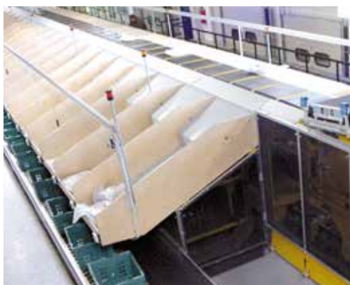
Particolare laterale delle celle di classificazione.
